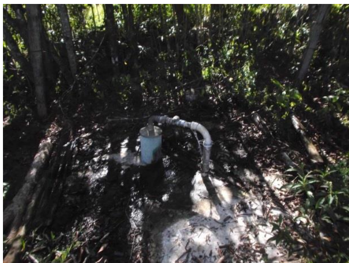
Figura 12: Solução Alternativa Coletiva Linha Sete de Setembro Ponto de captação Linha Sete de Setembro Coordenadas Geográficas: 29°15.863'; 051°46.935'
